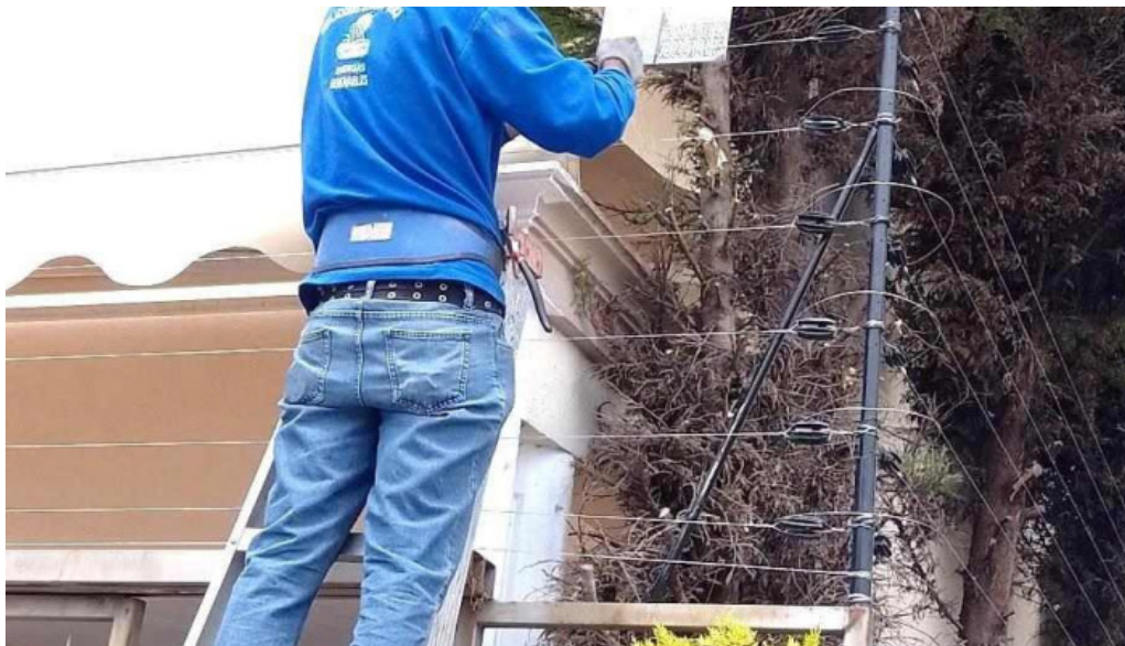
Instalaciones electricas toluca paneles solares del propietario
