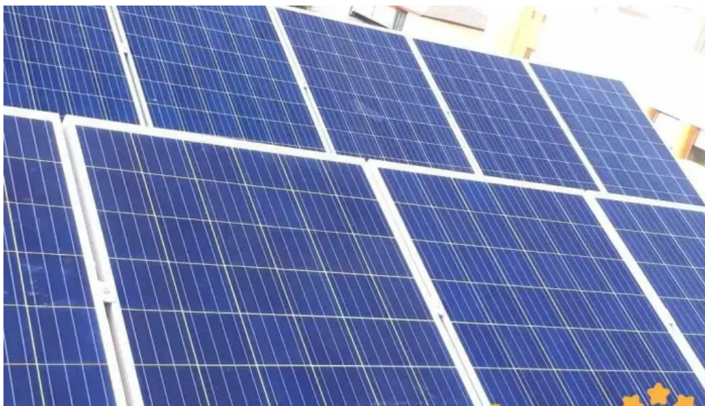
Instalaciones electricas toluca paneles solares videos
