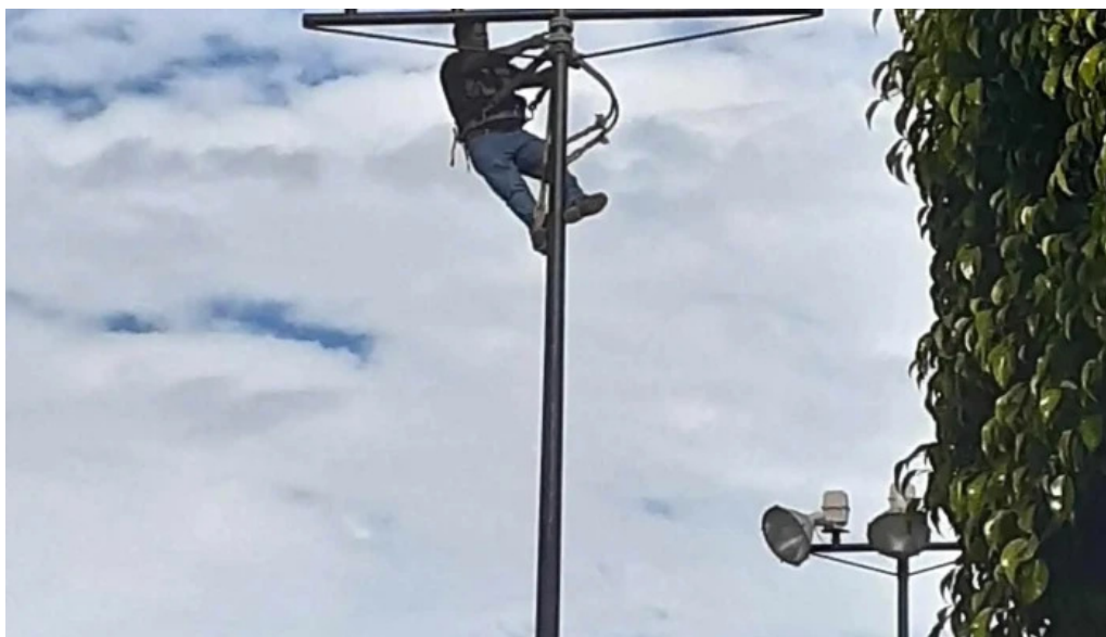
Instalaciones electricas morales del propietario
