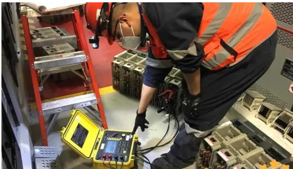
Mantenimiento y pruebas a sistemas electricos del propietario
