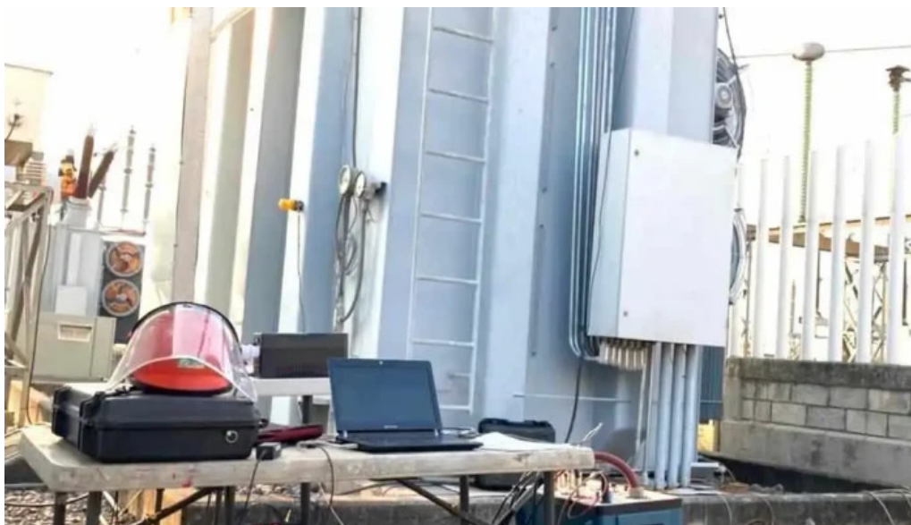
Mantenimiento y pruebas a sistemas electricos cerca de mi
