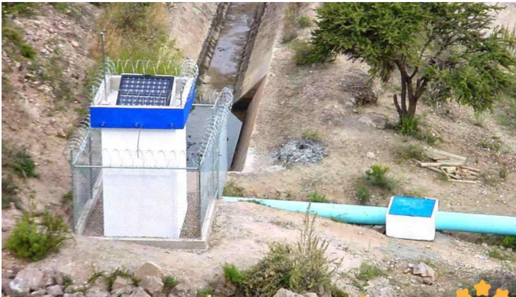
Electro instalaciones corporativo s c del propietario
