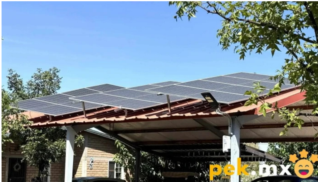
Energysync tech solutions electrica y telecomunicacion marod opiniones
