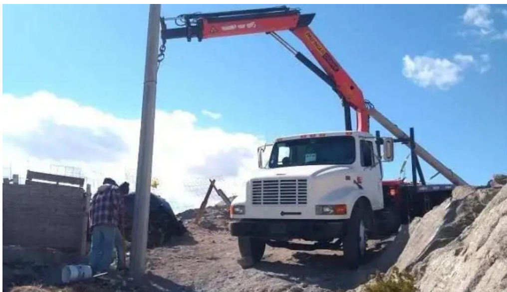
Energysync tech solutions electrica y telecomunicacion marod del propietario
