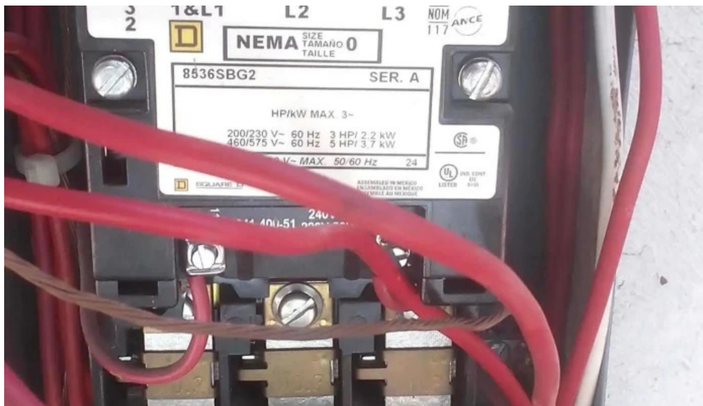
Plomeria y electricidad sima sistemas de mantenimiento integral ubicacion
