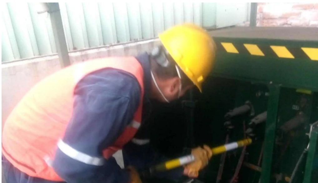
Servicios de mantenimiento electrico industrial aleo san miguel almoloyan
