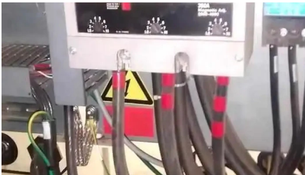
Instalaciones electricas media y baja tension cuautitlan izcalli
