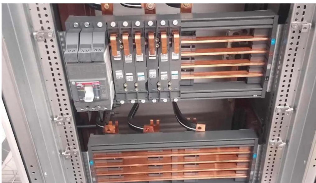
Instalaciones electricas media y baja tension mas recientes
