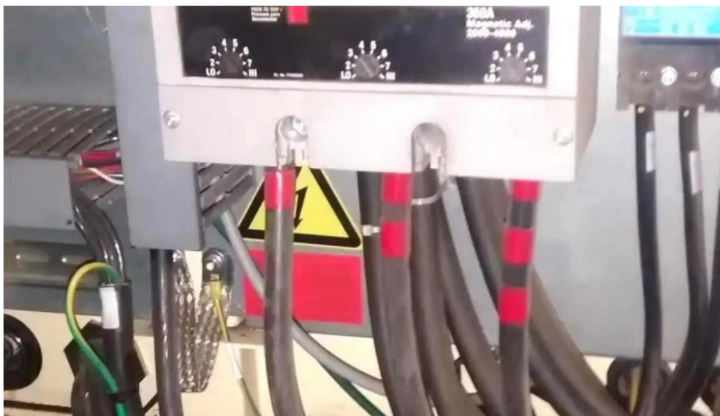
Instalaciones electricas media y baja tension precios
