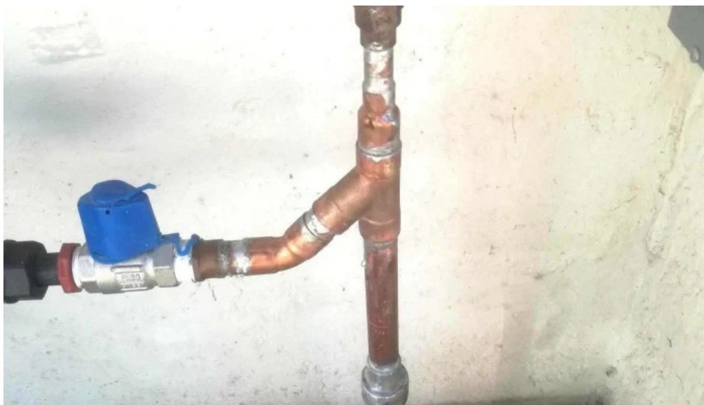
Rapido y bien plomeria y electricidad tuberia
