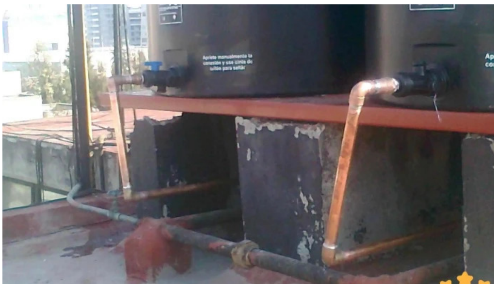
Plomeria y electricidad jimenez tuberia
