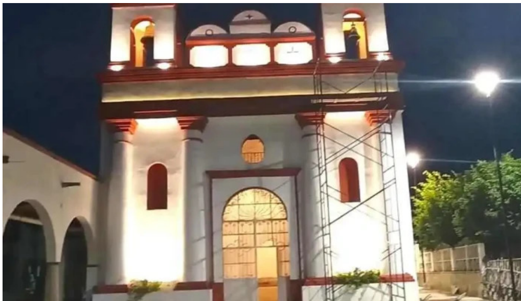
Franher electricidad exterior
