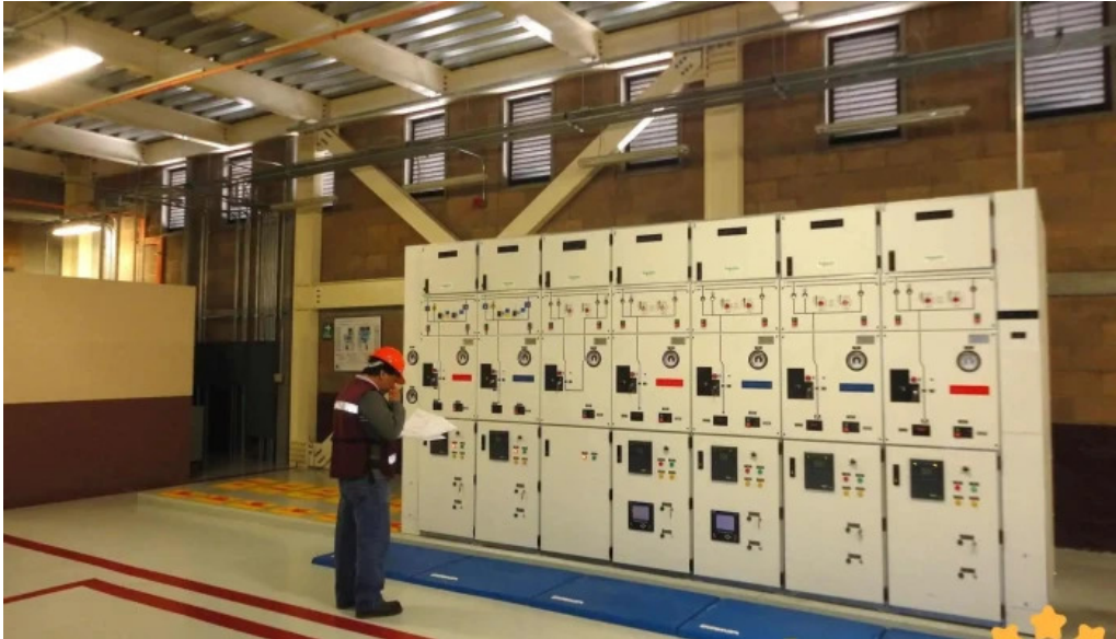
Proyectos y construcciones electricas interior
