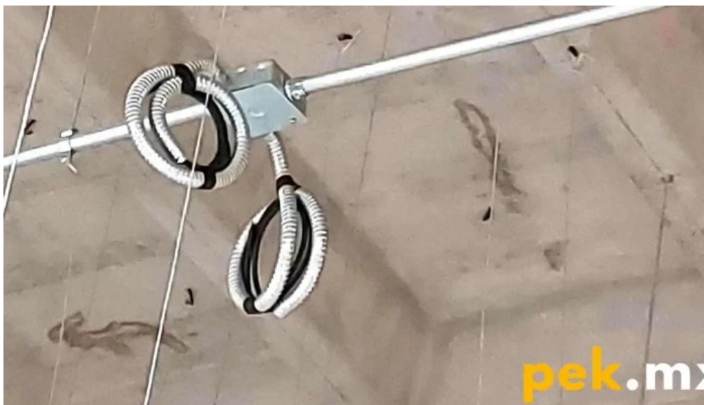
Instalaciones electricas para el hogar cerca de mi
