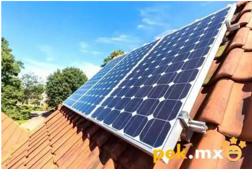
Instalaciones electricas y paneles solares aleman purepero de echaiz
