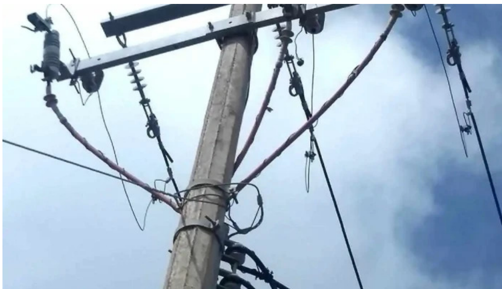
Instalaciones electricas y automatizacion del propietario
