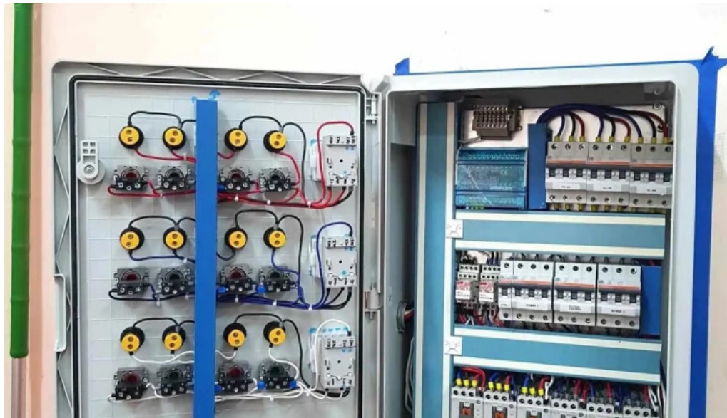
Phi servicios electricos interior
