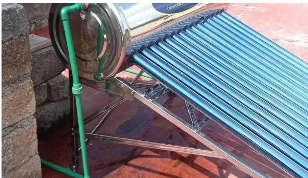
Servicio plomeria y electricidad telefono
