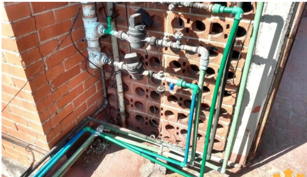
Plomero y electricista coacalco servicio metelec interior
