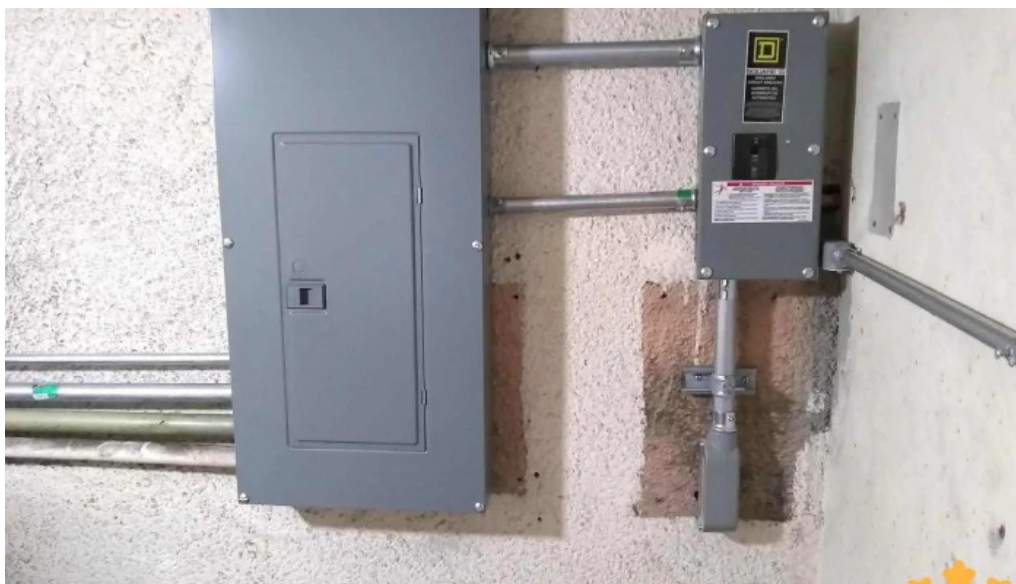
Electricista paneles solares abierto ahora
