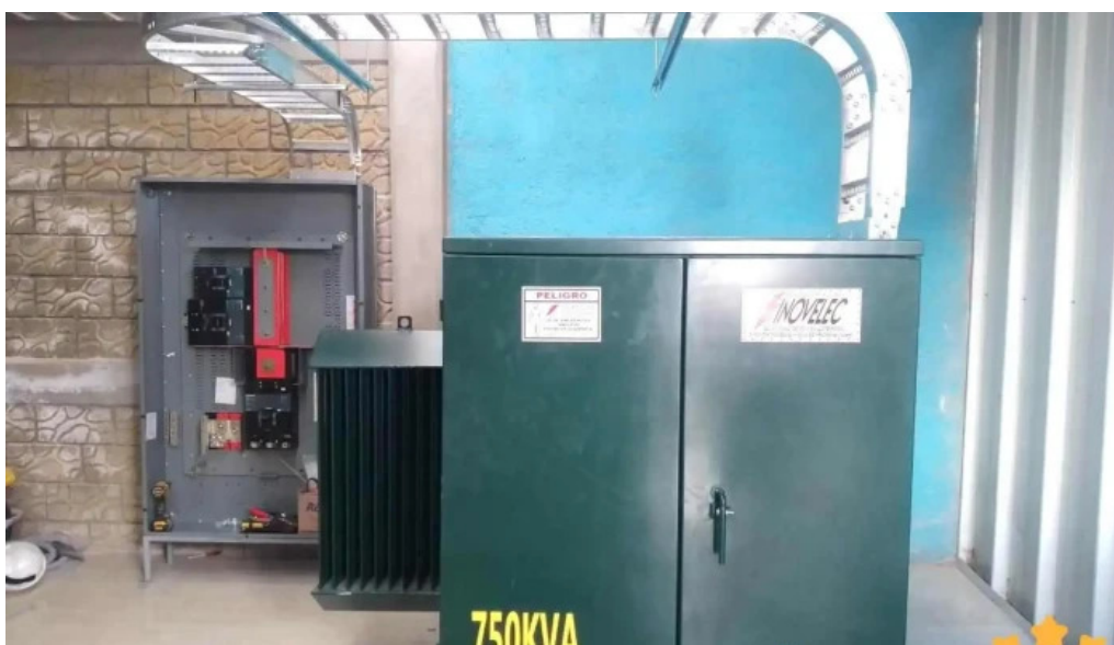
Instalaciones electricas industrial y residencial en baja y media tension exterior
