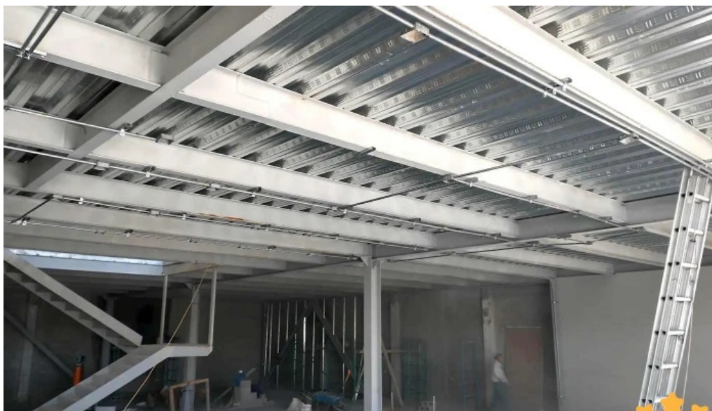
Instalaciones electricas industrial y residencial en baja y media tension zona
