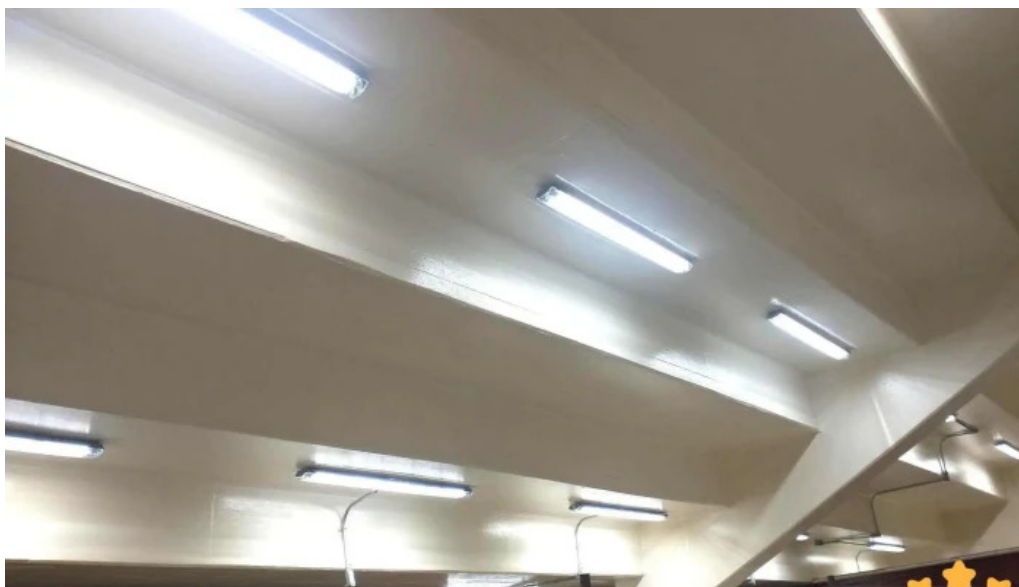
Instalaciones electricas industrial y residencial en baja y media tension del propietario
