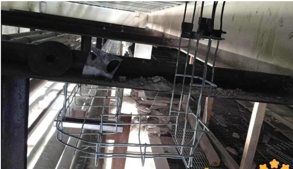
Electricista inselect instalaciones electricas chalco de diaz covarrubias
