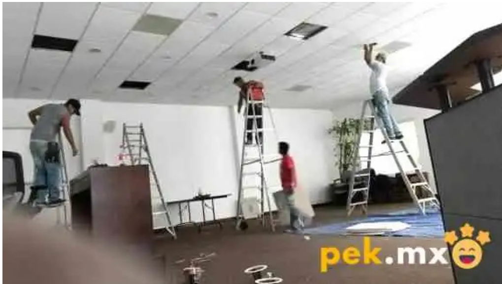
Instalaciones electricas aguilar interior
