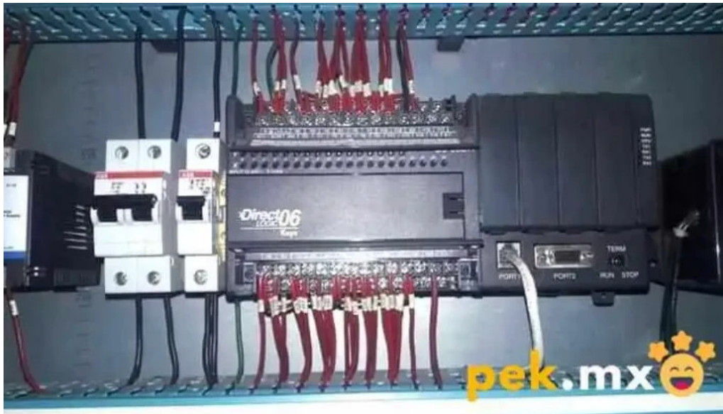
Electromar mantenimiento electrico inds sitio web
