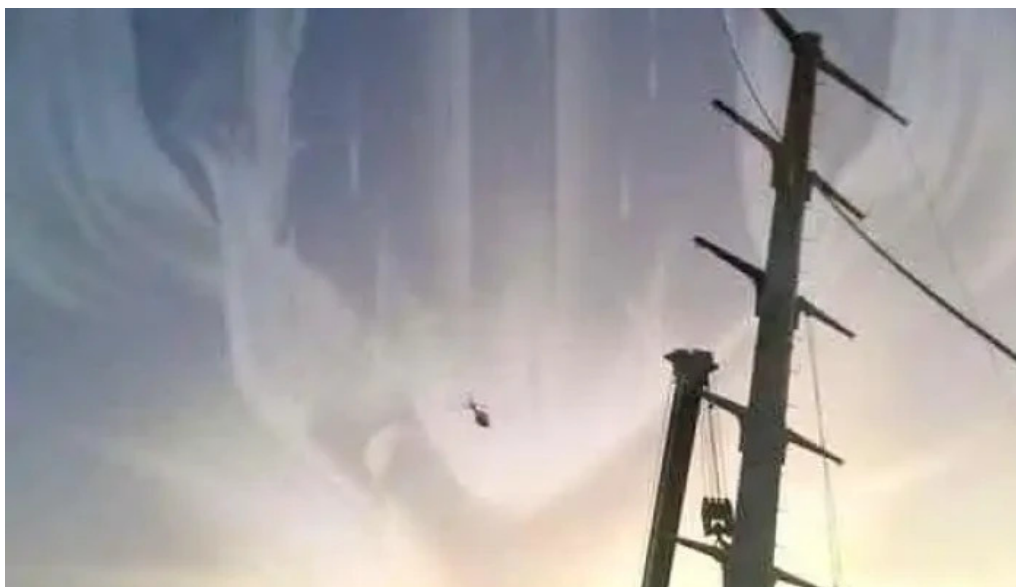
Construcciones electricas petave carapan
