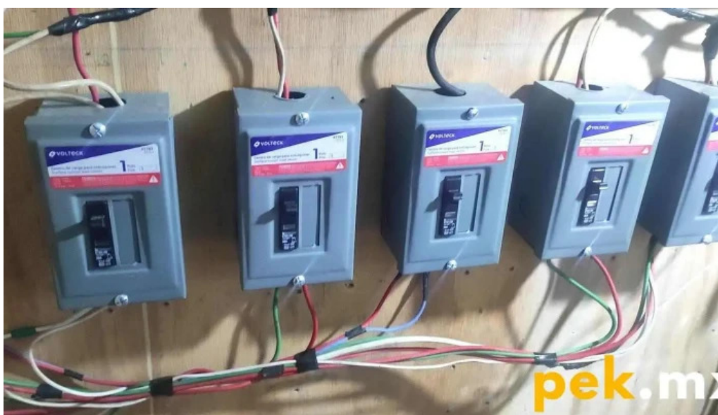
Plomeria y electricidad torres benito juarez ciudad de mexico
