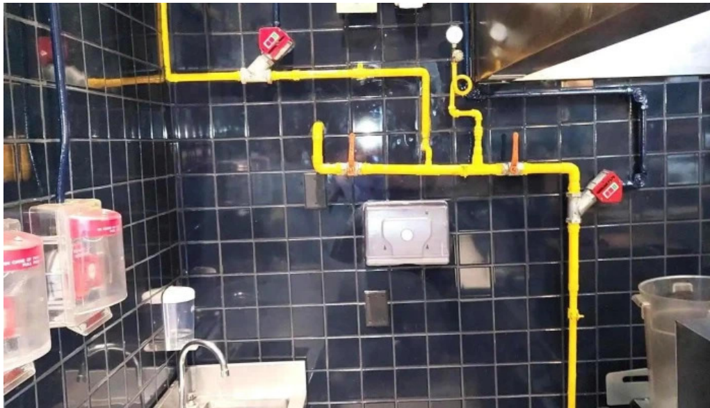
Plomeria y electricidad rodriguez cocina
