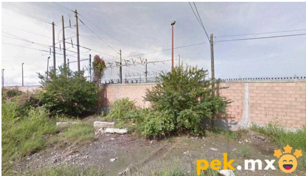
Subestacion electrica villa union villa union
