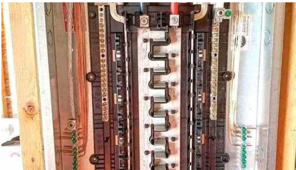
Electricidad y cctv eduherez puntaje
