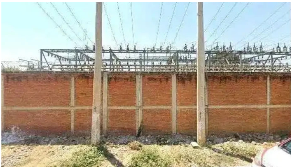
Subestacion oaxaca poniente cfe numero
